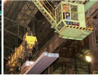
天井クレーン
